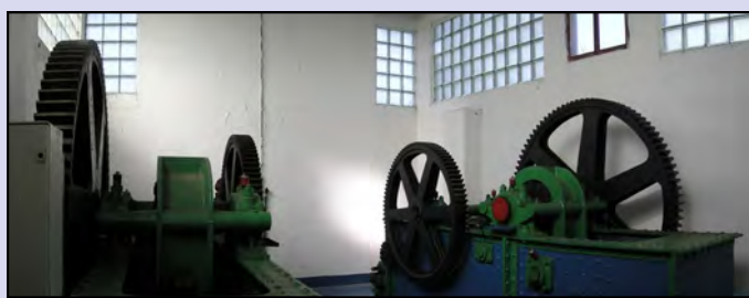
Strojovna ke zdvihu stavidel v pilířovém nástavci jezu.
