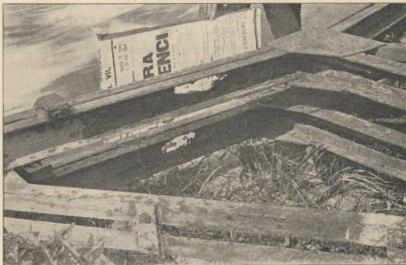
Obr. 8. Vliv vltavského vodního prachu zaneseného větrem na nejhořejší díl nýtované slupice libčického jezu.
